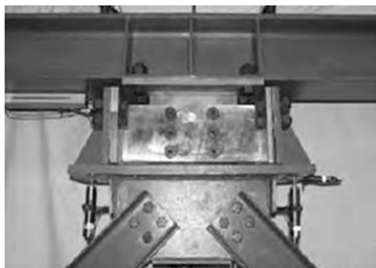
شکل ۳. FBP نصب‌شده در محل اتصال مهاربند با تیر طبقه. [۹]
